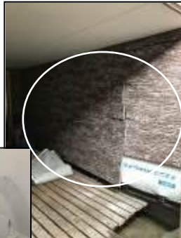
駐車場裏サイディング壁
